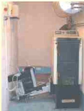
Gorilnik montiran v obstoječo peč s podkuriščem in odvzemom iz silosa.
